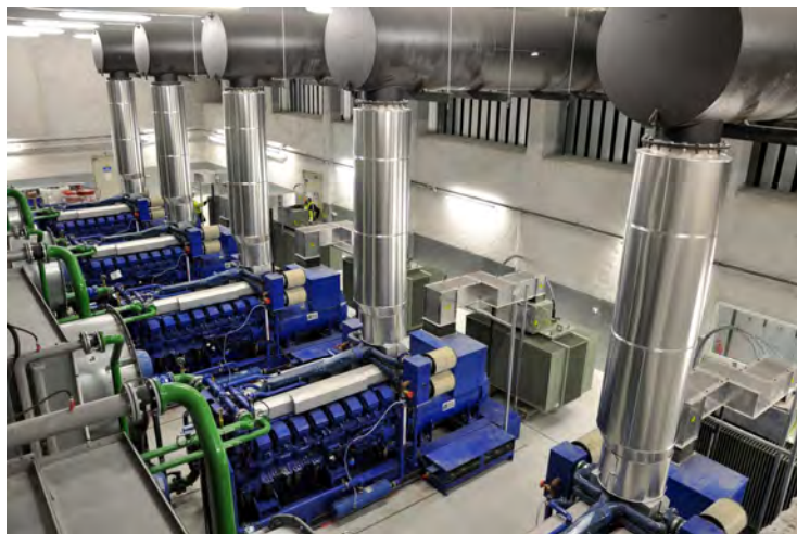
Le pôle énergie
